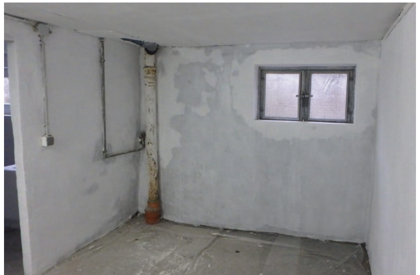
Die Keller der Wohnhäuser Hauptstrasse 42 bis 52 müssen endlich ordentlich saniert werden!
