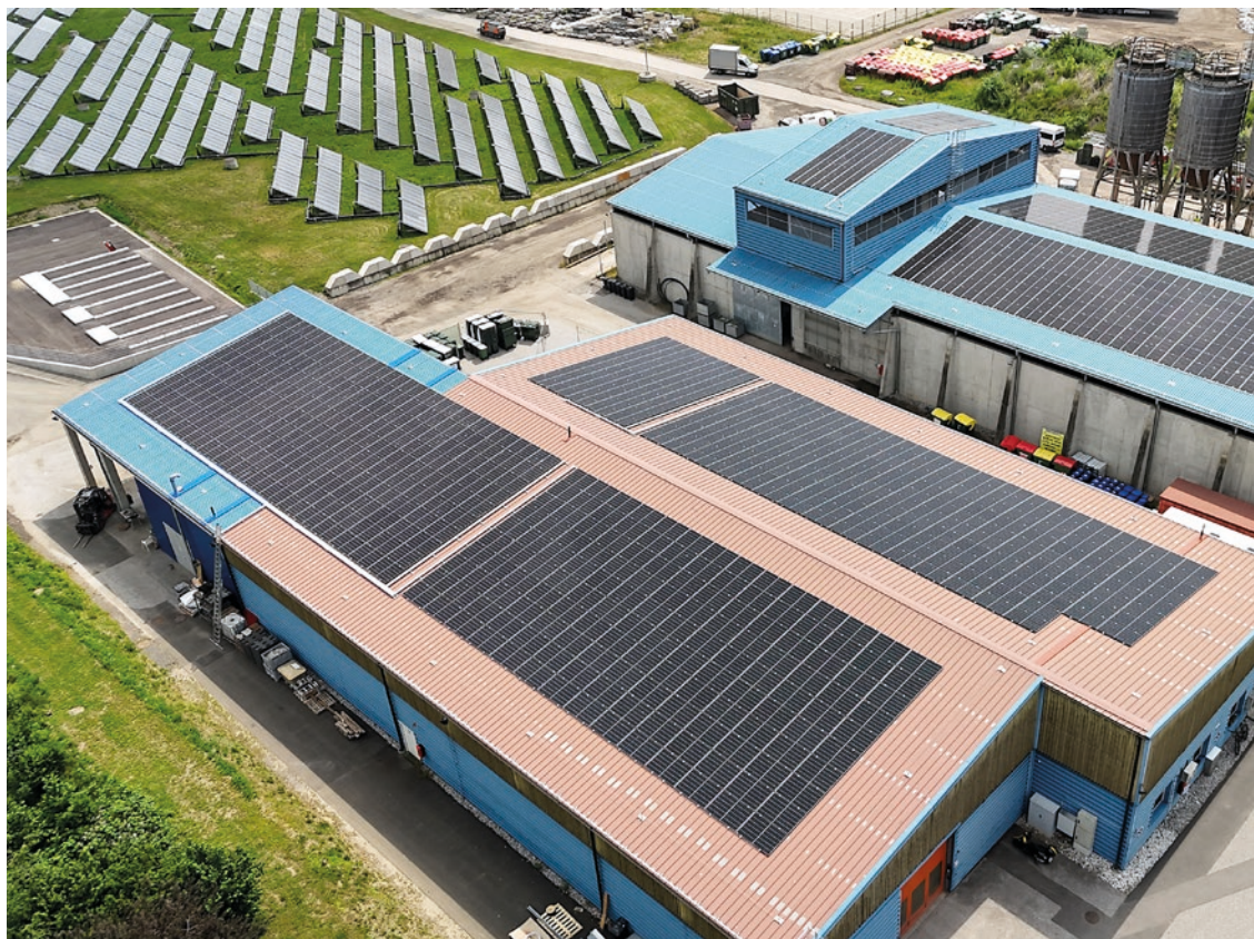
In der Maggstraße hat die Holding Graz großflächige Sonnenkollektoren installiert.
