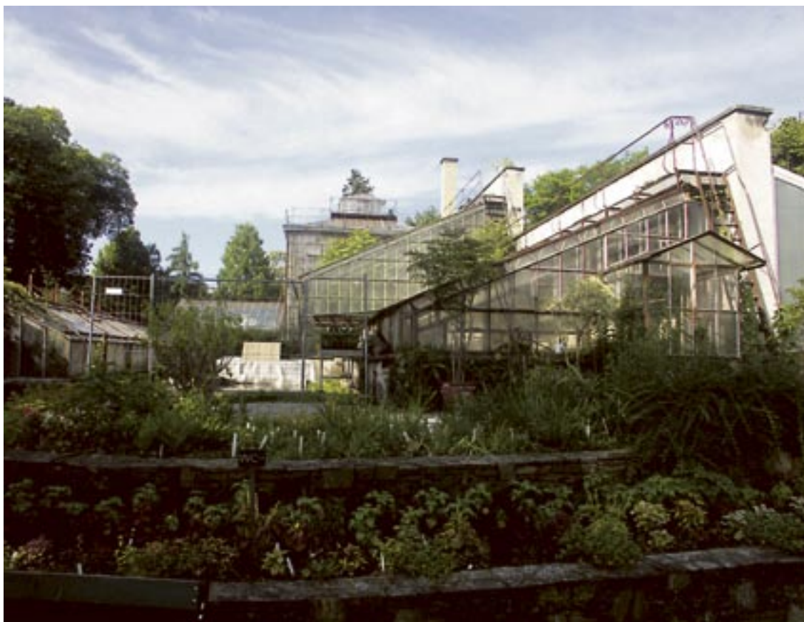
1888 wurde das alte Gewächshaus in der Schubertstraße errichtet, 1995 außer Betrieb genommen. Seit 2008 steht es unter Denkmalschutz. Trotzdem verfällt es zusehends.
